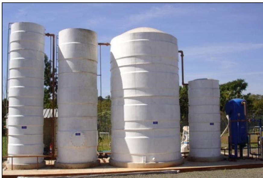
Figura 65 – Estação Compacta de Tratamento de Esgotos Sanitários.
