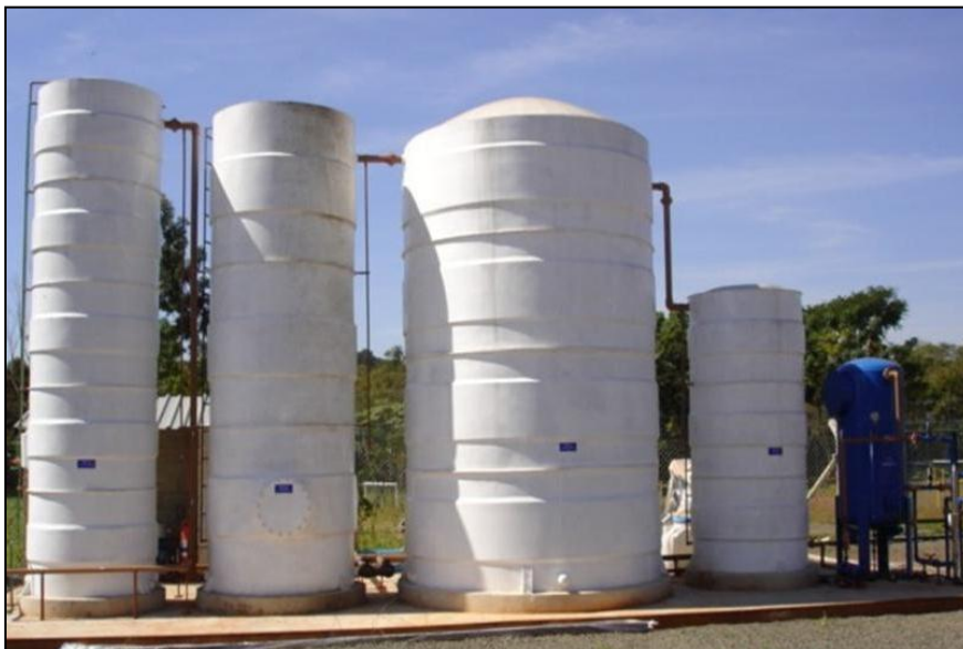
Figura 31 – Estação Compacta de Tratamento de Esgotos Sanitários.
